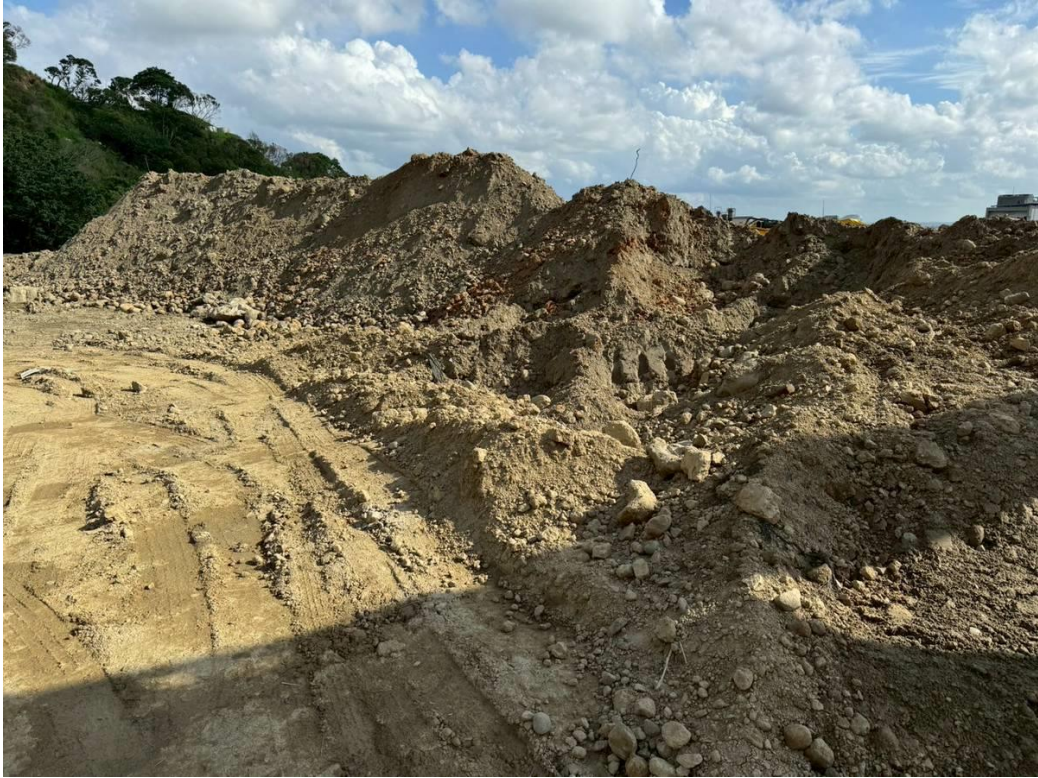
現場遭傾倒廢土高度達10餘公尺
