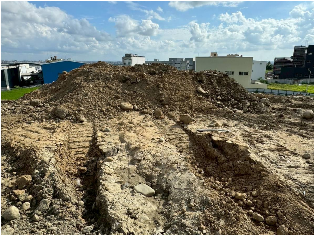
現場遭傾倒廢土高度達10餘公尺
