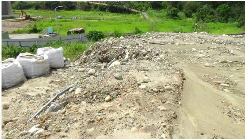
遭堆置之廢土內含有水管、磚角、瓦片等廢棄物
